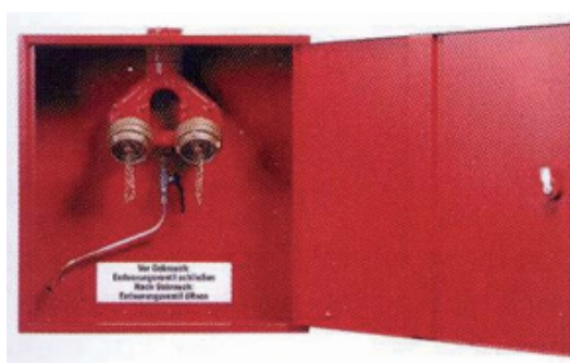
Slika 136: Mesto za dovod vode
