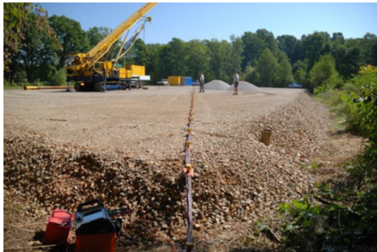
Slika 13: Po nasipu (fotografija) so se izvedle meritve MASW na profilih A in B. Primer profila A: zgornja slika prikazuje meritve pred izvedbo gruščnatih kolov, spodnja slika pa po njej. Povečanje strižnih seizmičnih hitrosti vzdolž profila je očitno. Na grafih (desno) so izračuni spreminjanja povprečne strižne seizmične hitrosti do globine 30 m (zahteva Evrokod) za profila A in B. Povišanje V_{s30} je vidno tudi z grafov.
