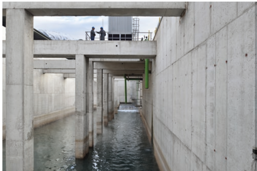
72. Bazeni za hladilno vodo na liniji za toplotno obdelavo specialne debele pločevine, SIJ Acroni Jesenice, projektant: Esotech / Savaprojekt, 2017 • Pool of cooling water line for heat treatment of special thick sheet metal, SIJ Acroni Jesenice, designer Esotech / Savaprojekt, 2017
